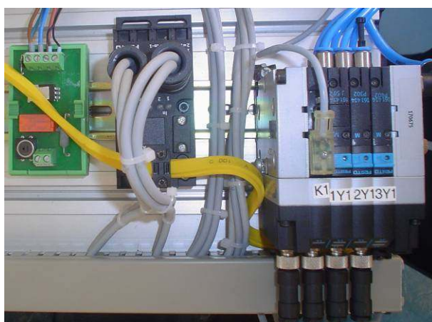
Detalhe do terminal de válvulas CPV e módulo de entradas
