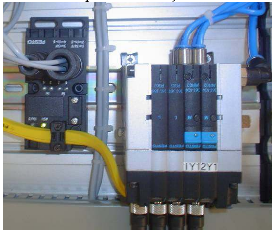
Módulos de IN/OUT da estação de montagem
